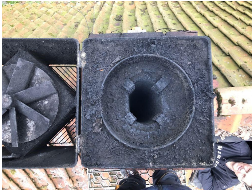
Defekt: der Rauchgassauger.
